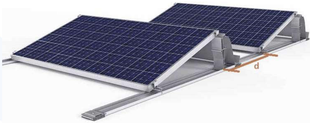
Imagem 01 – Fixação sobre laje impermeabilizada sem elevação.
